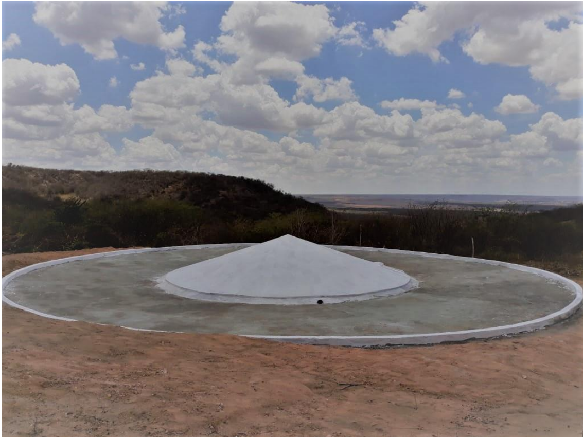
CISTERNA 52 MIL LITROS CHAPEU DO PADRE CICERO
